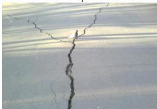
Рис. 10.1. Разрыв дорожной одежды в результате пучения грунта земляного полотна
